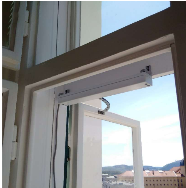
Donau-Universität Krems, Altbau, Kastenfenster automatisiert
