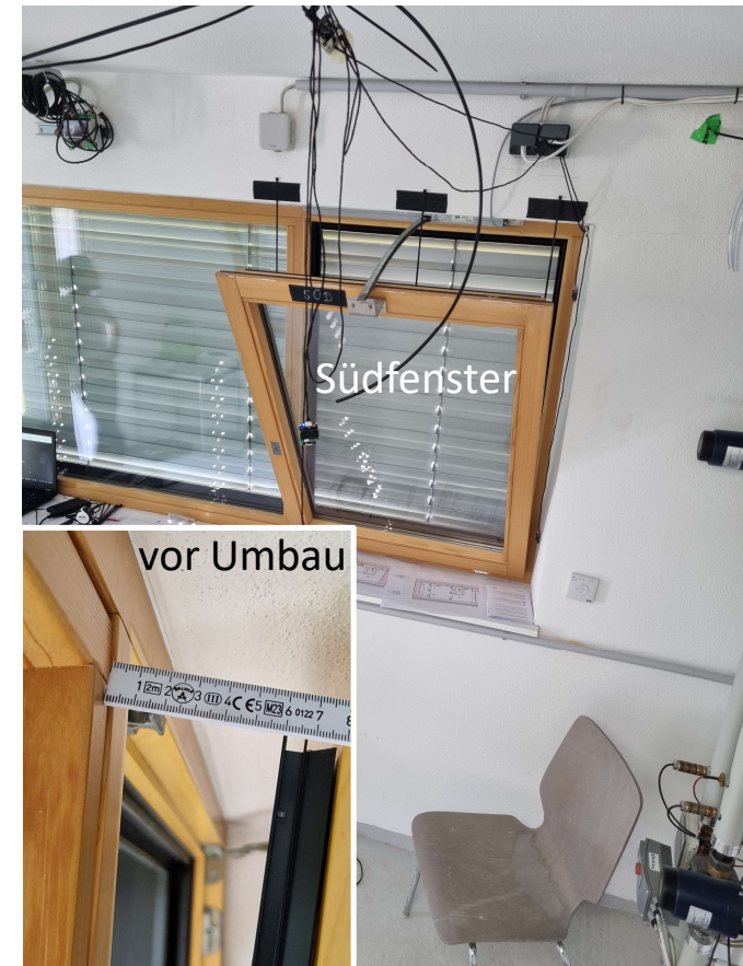
nachgerüsteter Kettenantrieb (Fa. WindowMaster) an Vertikalfenster SÜD
