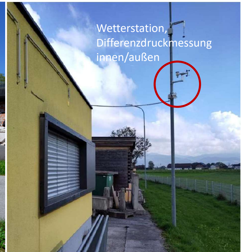
nachgerüstete Wetterstation am Laternenmast
