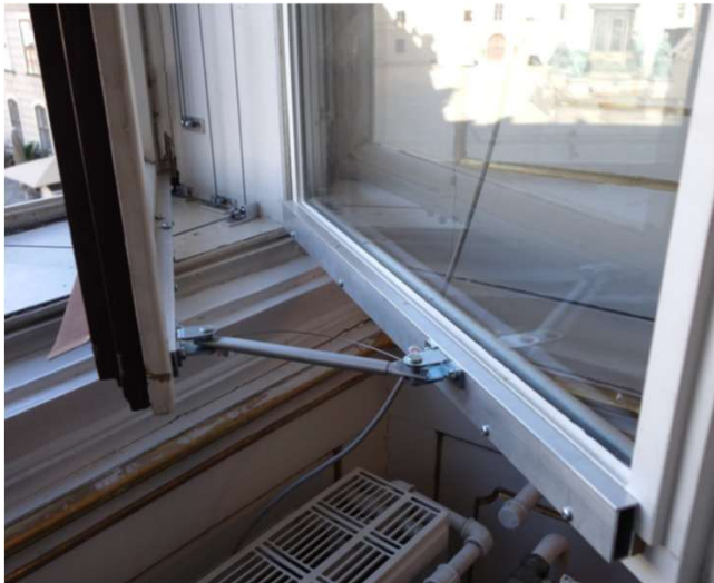
Hofburg Wien, Schweizerhof, Altbau, Kastenfenster automatisiert
